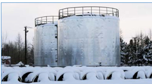
Пожарные емкости склада ГСМ локомотивного депо Коротчаево
